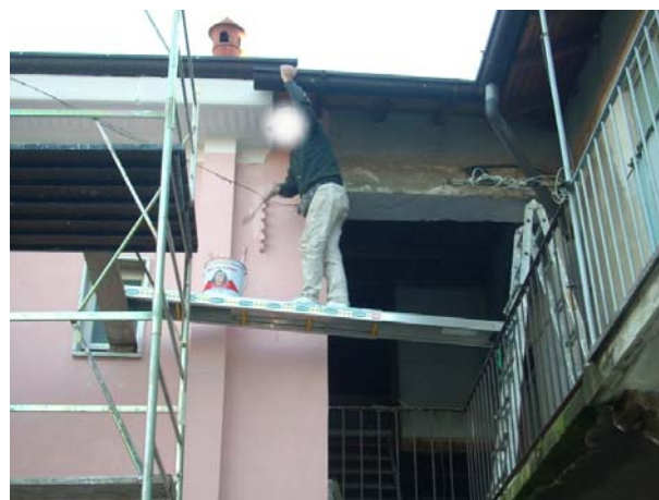
Cantiere a rischio
